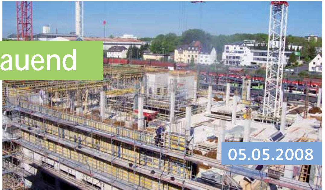
Hier entsteht etwas Großes, auch wenn Minibagger immer wieder einmal auf der Baustelle gesehen werden.
